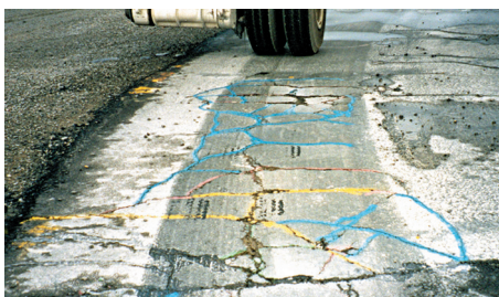
Fissuration d'une structure souple
